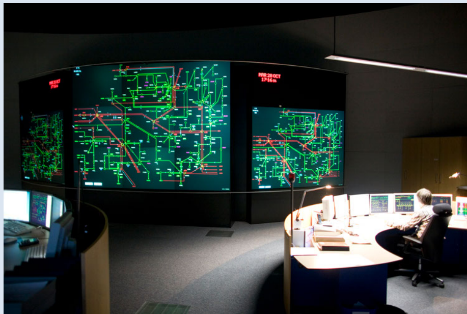
Figure 20 - Conduite d'exploitation électrique RTE 32
